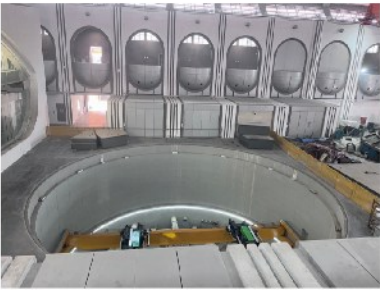
项目名称 浙江大学超重力实验室 项目地点 杭州 应用产品品类 智控电源线缆.....
